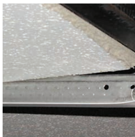
Las Tés secundarias sin soporte hacen que los plafones se desprendan.
